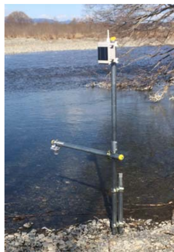
写真 1.3 超音波水位計測
